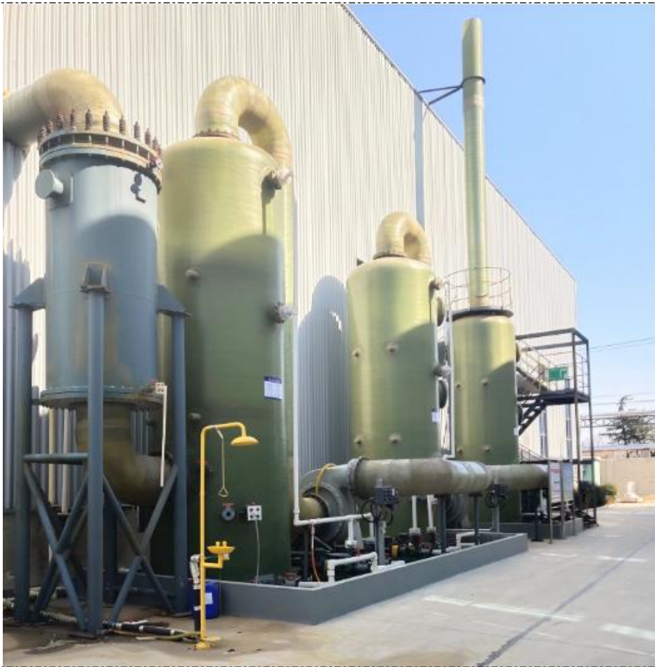
聚合氯化铝车间二级水喷淋+一级碱喷淋及废气排气筒（DA004）
