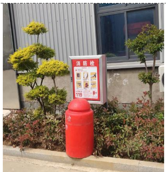
室外消防栓及消火栓
