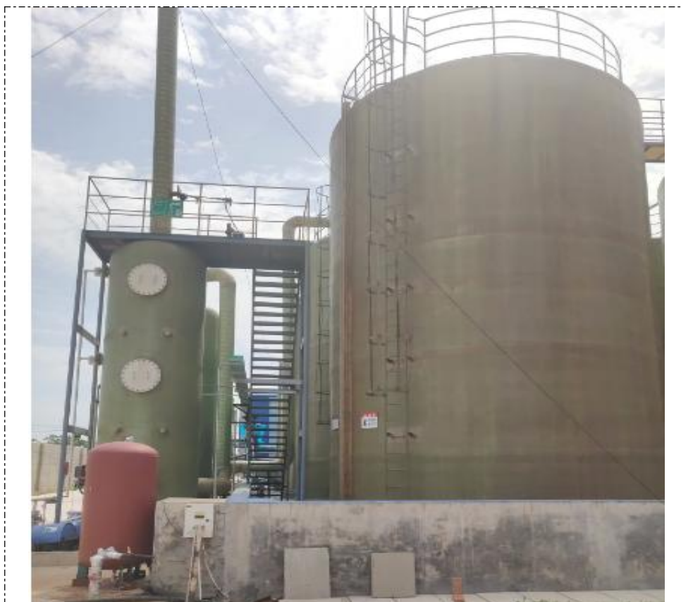
盐酸储罐二级水喷淋+一级碱喷淋及废气排气筒（DA003）
