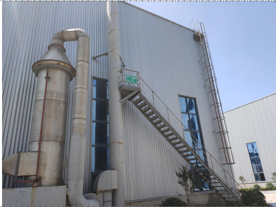
铝灰渣暂存库水喷淋装置及废气排气筒（DA001）
