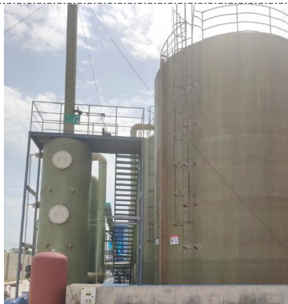
盐酸罐区废气排放口规范化建设
