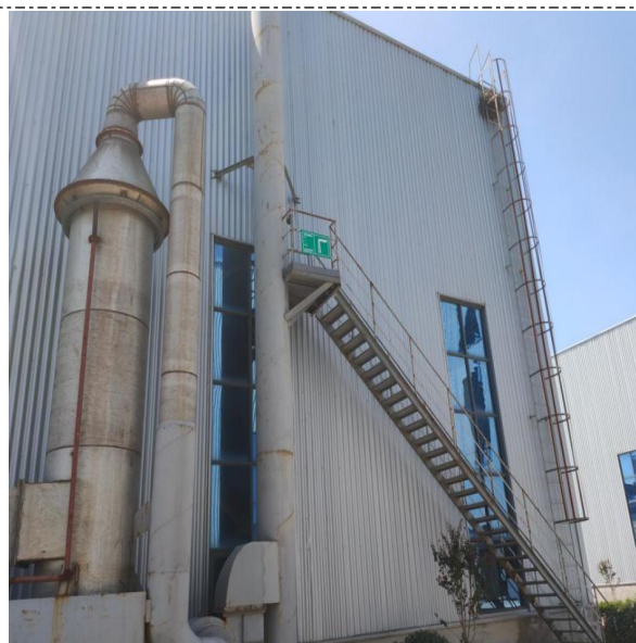
铝灰渣暂存库废气排放口规范化建设
