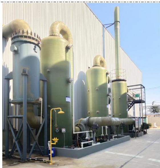
聚合氯化铝车间废气排放口规范化建设
