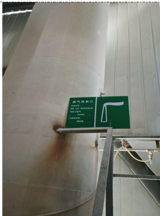
制砂工序废气排放口规范化建设
