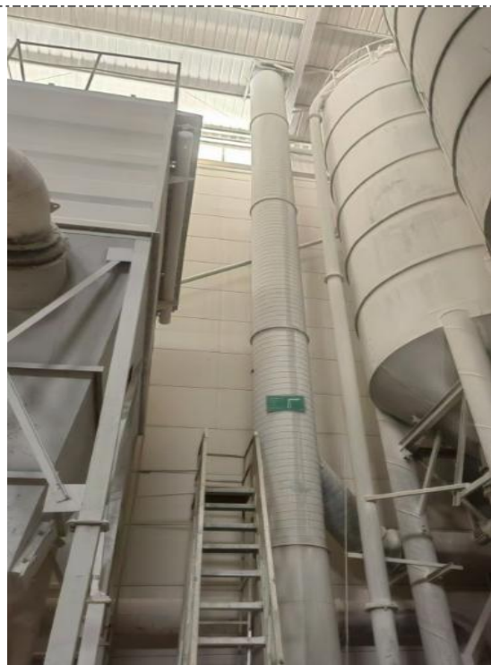
粉磨工序废气排放口规范化建设
