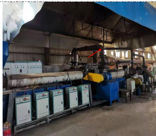
图 4-1 3 段挤出废气收集系统
