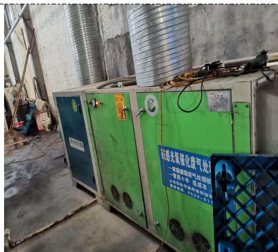
图 4-2 注塑废气处理设施
