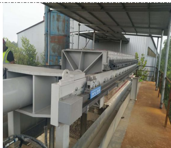
图 4-5 废水处理板框压滤机
