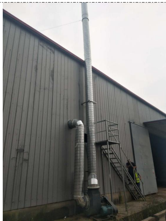
图 4-6 洗砂投料工序排气筒检测平台
