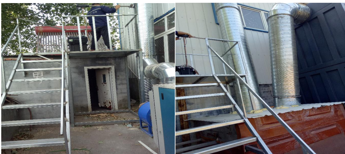
图 4-3 烘烤工序废气采样平台
